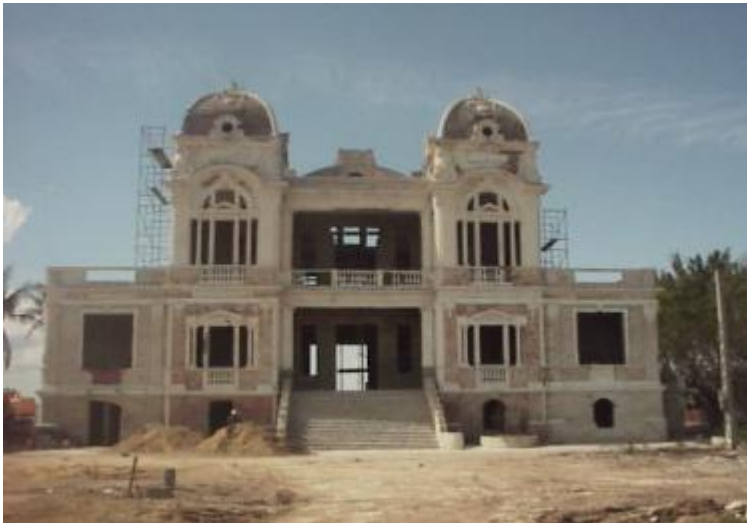
Yacht Club, Cienfuegos (cúpula con problemas técnicos)
